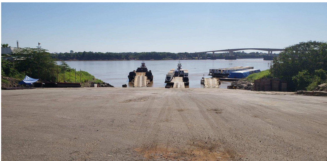
Figura 65. Falta de sinalizações horizontal e vertical, condição regular do pavimento flexível da Rampa Ro-Ro. (Em segundo plano, encontram-se as rampas flutuantes (nas extremidades esquerda e direita) e a rampa “charriot” - porção central).
